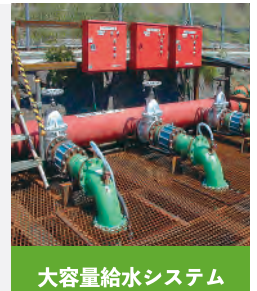
給水ユニット型ポンプ
